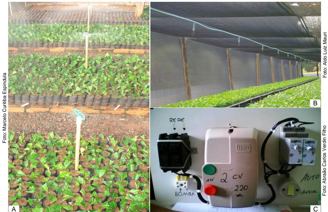
Figura 5. Sistema de irrigação automatizado para viveiro de produção de mudas clonais de C. canephora . Microaspersão com tubulação subterrânea (A). Microaspersão invertida com tubulação suspensa (B). Sistema de automação (C).
